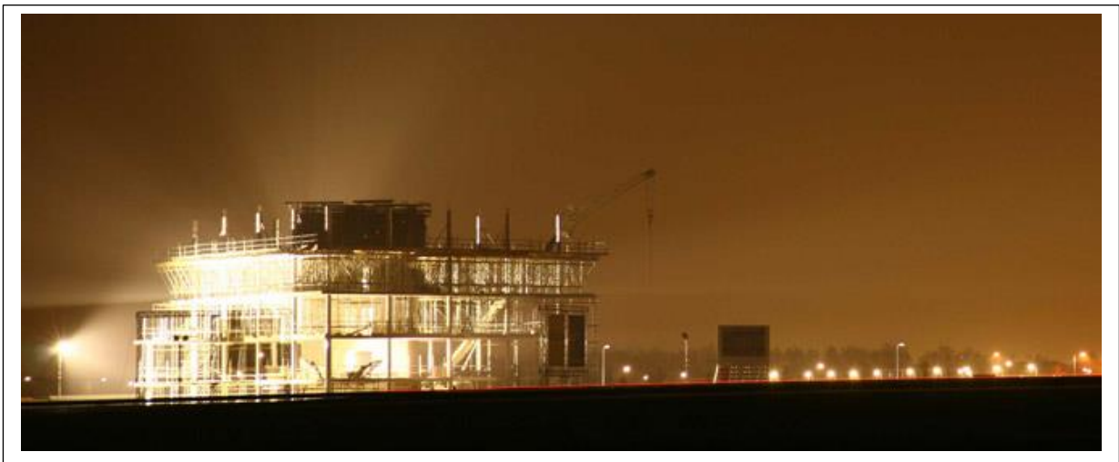
Voorbeeld van terreinverlichting. Foto: platform lichthinder / Sotto le Stelle.
