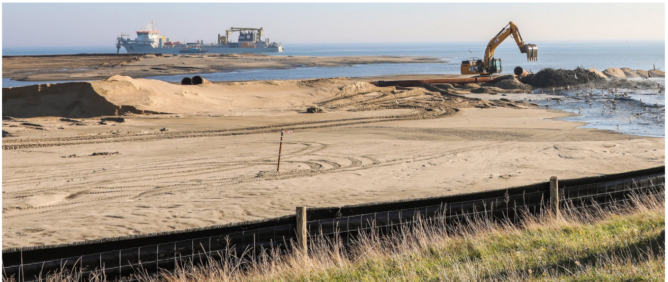
Figuur 3-20. Suppletiewerkzaamheden aan de Prins Hendrikzanddijk op Texel (foto via Jan de Nul)
